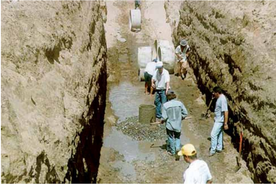
Foto 9 –Aspecto da Vala de uma Barragem Subterrânea Vendo-se, ao Centro, a Fundação do Poço Amazonas
