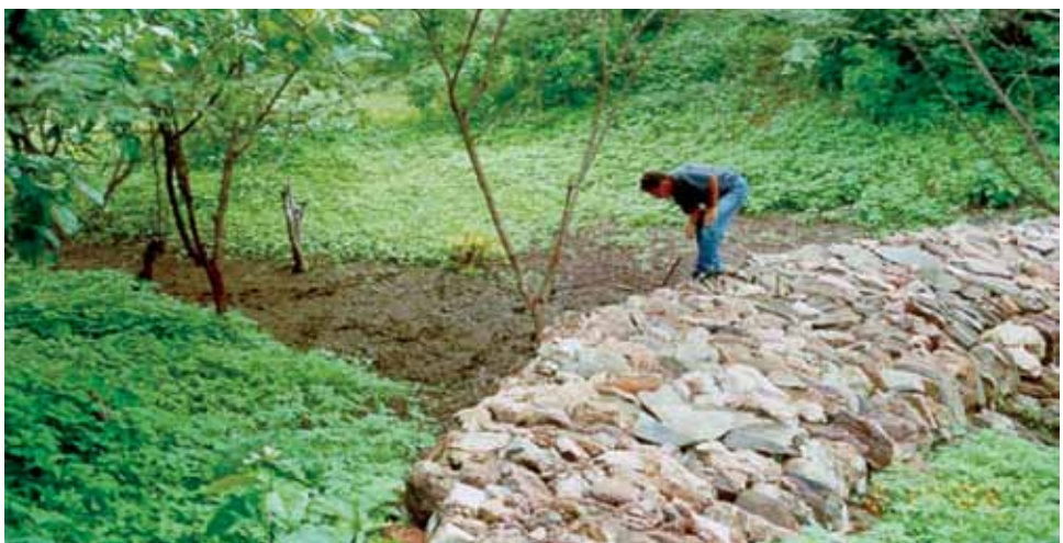
Foto 7 - Efeito da Retenção de Sedimento e Ressurgimento da Vegetação Arbórea e Herbácea, após o Período de Inverno. Fonte: João Bosco de Oliveira.
